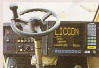
▲クレーンエンジンの反対側に位置したクレーン操作室は雑音をシャットアウト
